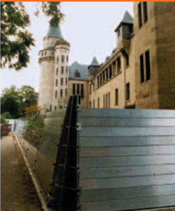
Mobiler Hochwasserschutz mit Dammbalken
