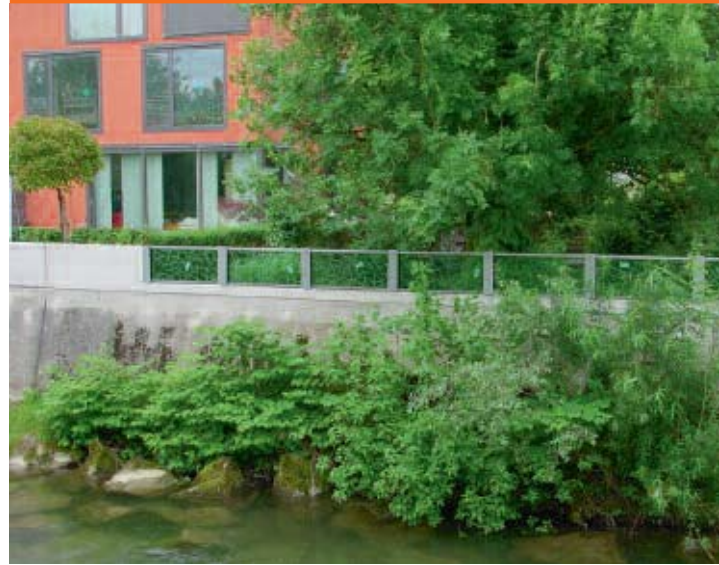
Hochwasserschutzwand mit Sicherheitsglas
