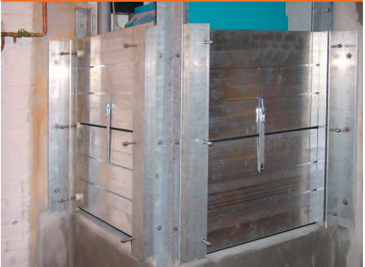
Sicherung eines Heizungsbrenners
